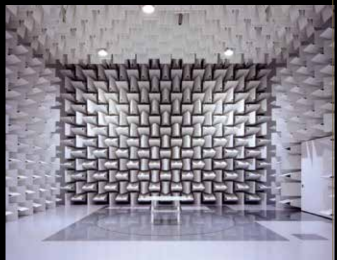
電波暗室用ターンテーブル 提供 株式会社トーキンEMCエンジニアリング
